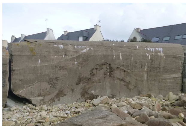
2018-M3-6-0 basculé et affecté par des épaufrures en parement et en couronnement
