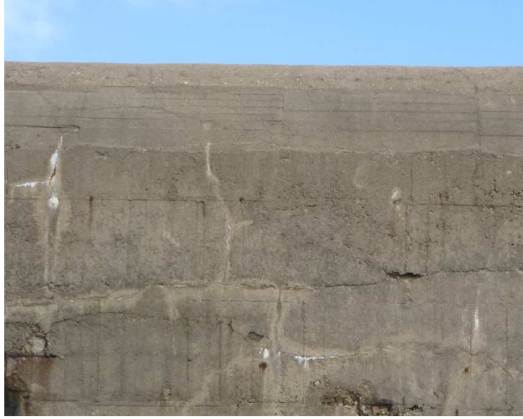
Bloc 2018-M1-B-19-0 affecté par des discontinuités subhorizontales et un réseau de fissure superficiel trahissant le ferrailage de peau
