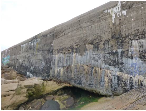
Vers P455, sous-cavage de 1.8m de profondeur avec fortes circulations d'eau au droit du bloc 2018-M4-B-4-0
