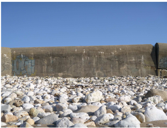
bloc 2018-M2-B-1-0 montrant un parement maritime subvertical marqué par la trace d'une fissuration subhorizontale à oblique traversante mais non ouverte liée à des reprises de bétonnage
