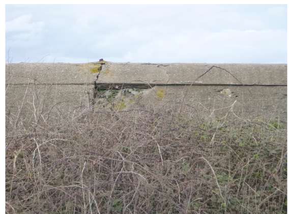
Couronnement du bloc 2018-M4-B-3-0 affecté par de rares épaufrures (0.7m de long)
