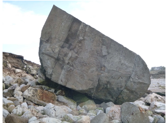
Bloc 2018-M1-B-11-0 renversé sur une grève et affecté de quelques épaufrures en rive
