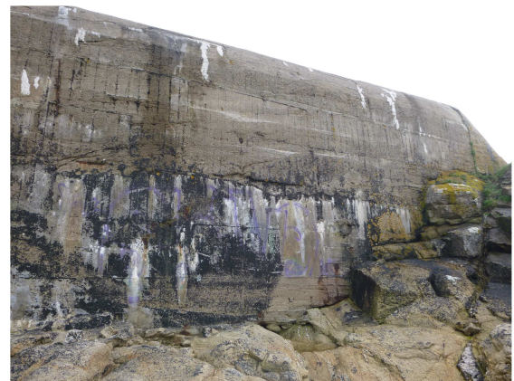
Sud du parement maritime du bloc 2018-M4-B-4-0 affecté par une fissuration subhorizontale soulignée par des efflorescences
