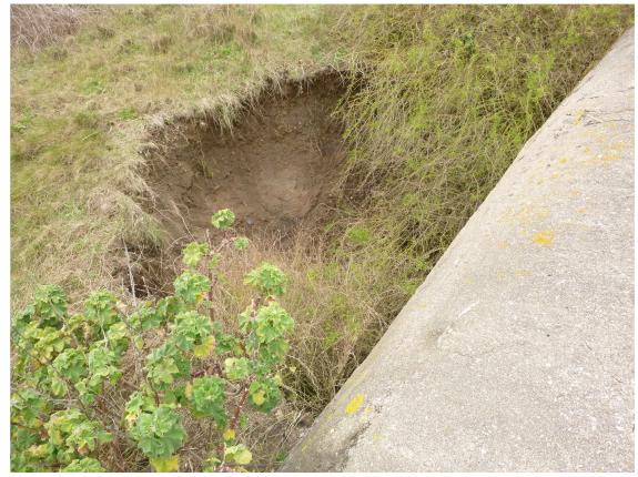
Vers P455, dépression au droit du bloc 2018-M4-B-4-0 de ~5m de long sur ~4 m de profondeur
