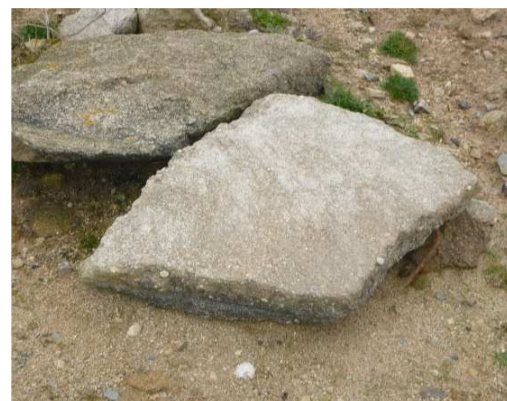
Au droit d'un accès à la plage, à l'arrière du bloc 2018-M2-B-15-0, morceau de semelle avec armatures en saillie sur 20cm
