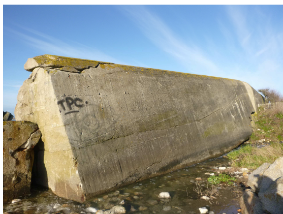
Fracturation en partie haute du bloc 2018-M2-B-2-0 sur ~ 2m de long associée à des épaufrures consécutives au mouvement des blocs 2018-M2-2-0 et 2018-M2-3-0
