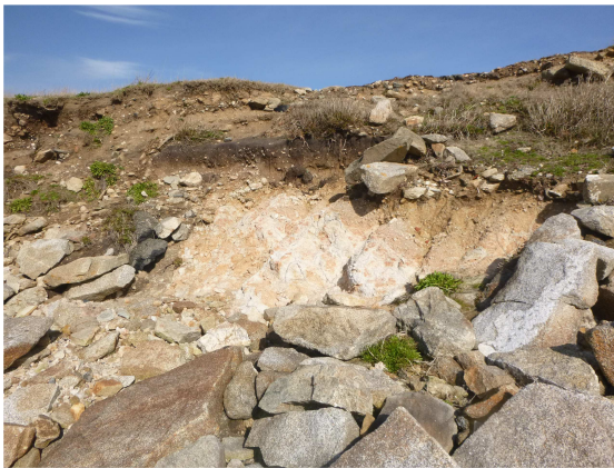
au droit du profil P50, micro-falaise de \sim 2.5 \text{ m} de haut entaillée dans un horizon basal argileux très humide dominé par un niveau tourbeux ( 0.2 \text{ m} ) puis un horizon d'altérites composé d'arène, de blocs et de gravats ( 1.2 \text{ m} )
