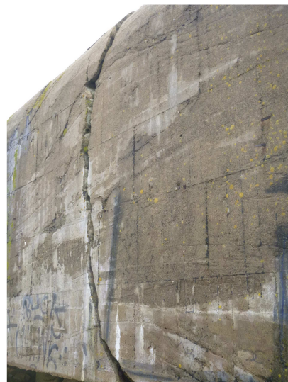
Fracture avec rejet horizontal pluricentimétrique en haut de mur M4
