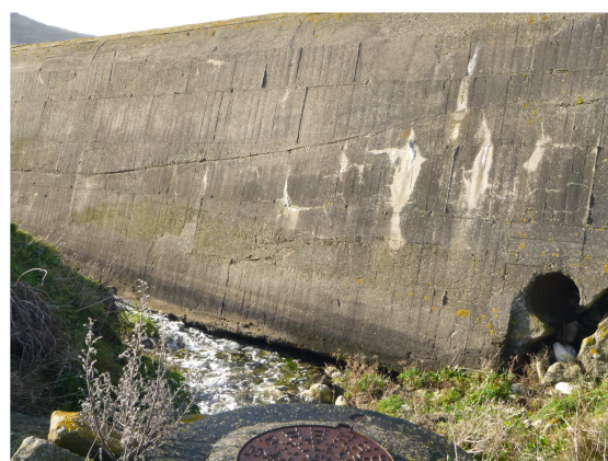
Affouillement du bloc 2018-M2-B-2-0
