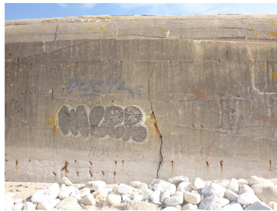
Bloc 2018-M2-B-14-0 affecté par de la fracturation verticale sans rejet à ouverture croissante vers la base (ouverture de 1.5cm à la base à quelques mm en tête) se développant sur toute la hauteur
