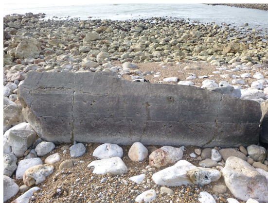
Bloc 2018-M1-B-6-6 rompu depuis 1966 et affecté par 3 fissures transverses continues de 5mm d'ouverture et distantes de ~1.8m
