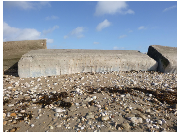
Bloc 2018-M2-B-5-0 affecté par une fissuration subhorizontale traversante correspondant à des reprises de bétonnage et 2 fissures subverticales continues mais peu ouvertes
