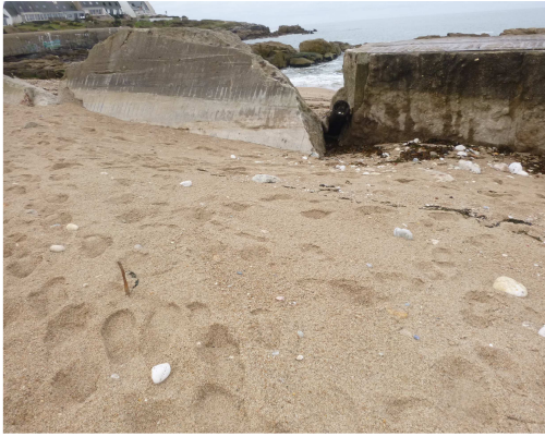
Sur la plage, à ~7m à l'arrière du bloc 2018-M2-B-12-0, armatures ressortant du sable sur 15cm
