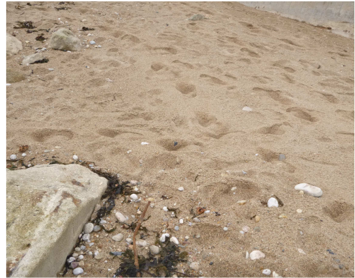
Sur la plage, à ~7m à l'arrière du bloc 2018-M2-B-13-0, armatures ressortant du sable sur 40cm
