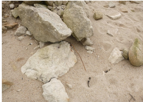
A proximité de la micro-falaise, au droit de la limite des blocs 2018-M2-B-13-0 et 2018-M2-B-14-0, armatures en saillie sur 80cm
