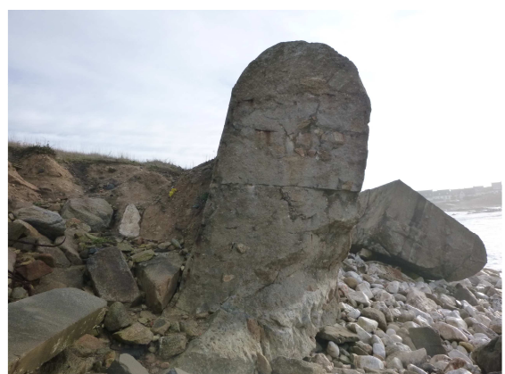
Bloc 2018-M1-B-10-0 montrant une inclinaison anormale vers l'aval du parement maritime de 82° significatif de son basculement
