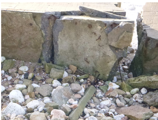
Ferrailage dans les débris à l'arrière du bloc 2018-M1-B-18-0
