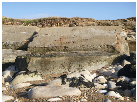
4 ème groupe de blocs résultant d'une fracturation survenue le long d'un joint de bétonnage
