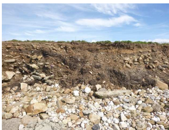
Ablation des matériaux glissés et redressement de l'escarpement par érosion marine Photo du 13 03 2018
