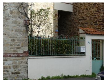
Mur de clôture différent du reste de la maison
