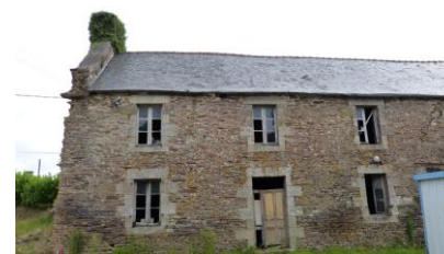
Attention à la dégradation du bâti ancien qui structure l'espace, et qui possèdent de nombreux détails intéressants
