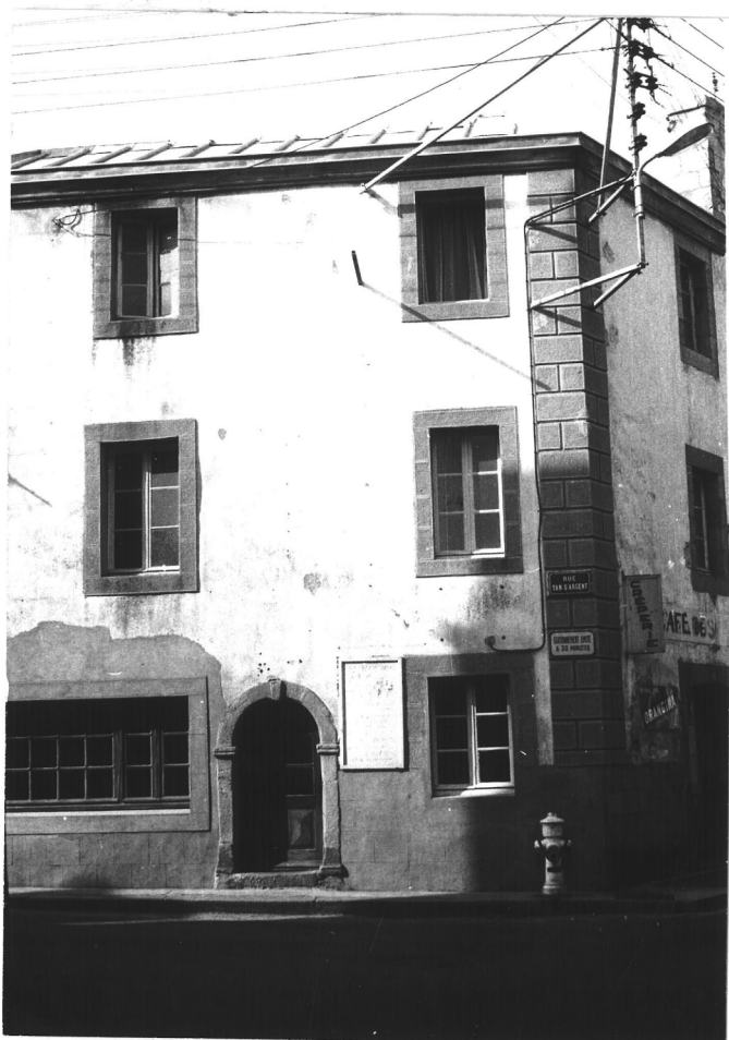
4/21A - Façade mal remaniée (chaînage d'angle et encadrements des ouvertures trop réguliers).
