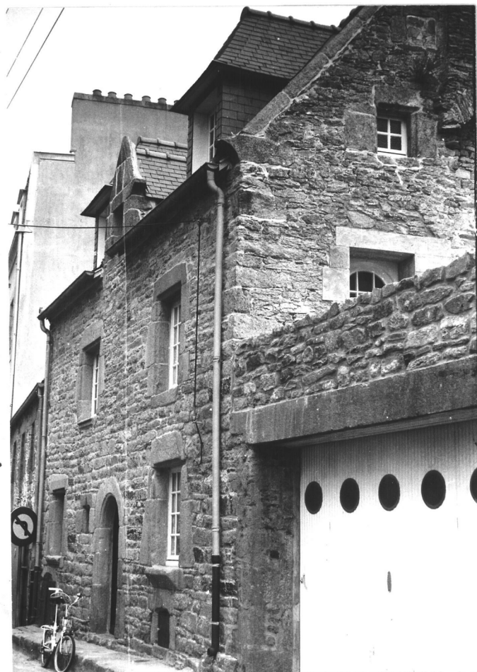
13/28 - La façade sobre de cette maison dans la tradition de l'habitat roscovite du XVII e siècle ; est malheureusement endommagée par les deux grosses lucarnes modernes.
