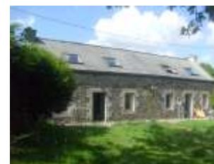
Impact de la multiplication des châssis de toit et de grandes dimensions
