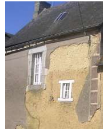
Détail d'enduit en terre recouvert d'une peinture – Le Bourg
