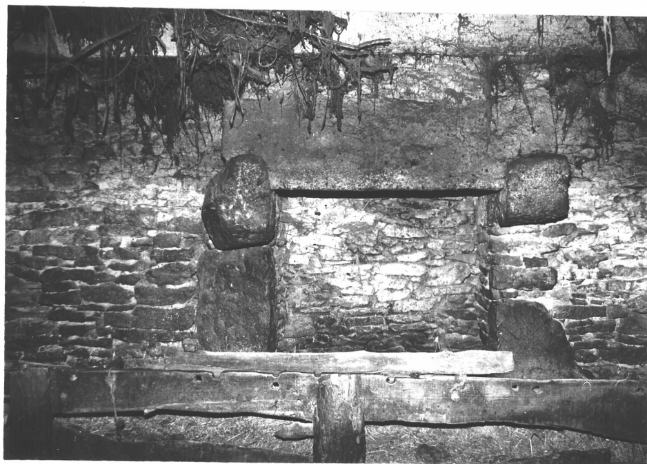
78.22.210 Z - MAISON B Cheminée.
